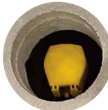
① Can Suyu Vanası
